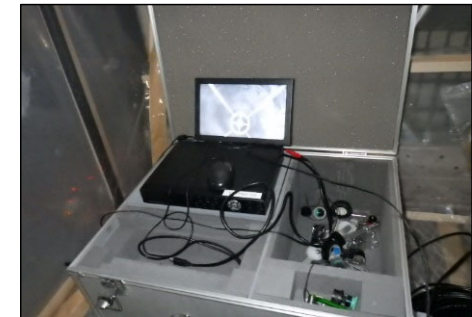
②煙突内部専用カメラ 専用噴霧器にカメラを設けているた め、噴霧状況を確認可能。
